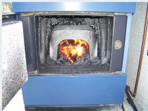
Combustione di biomassa in una caldaia familiare
