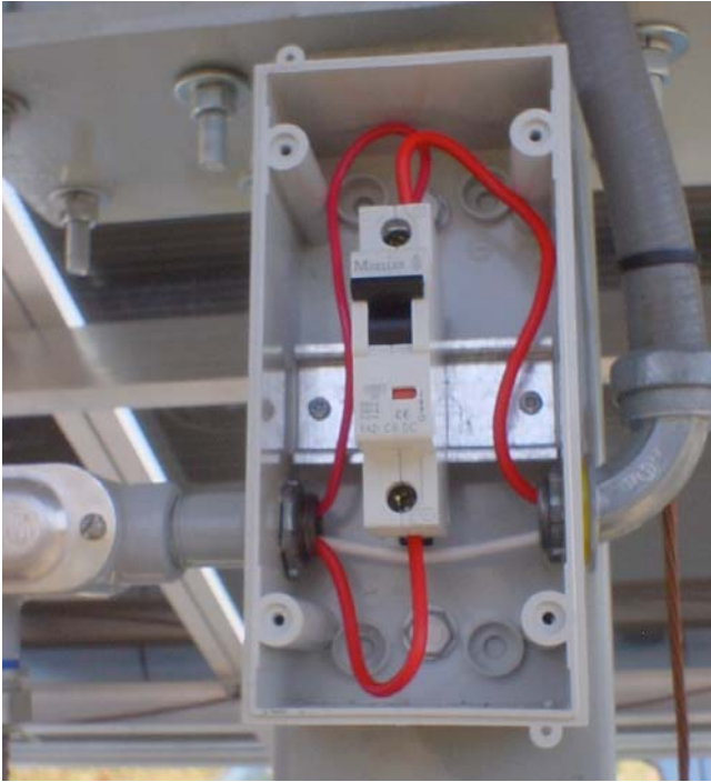
Fig. 5. Array disconnect using Moeller FAZ C6 DC
