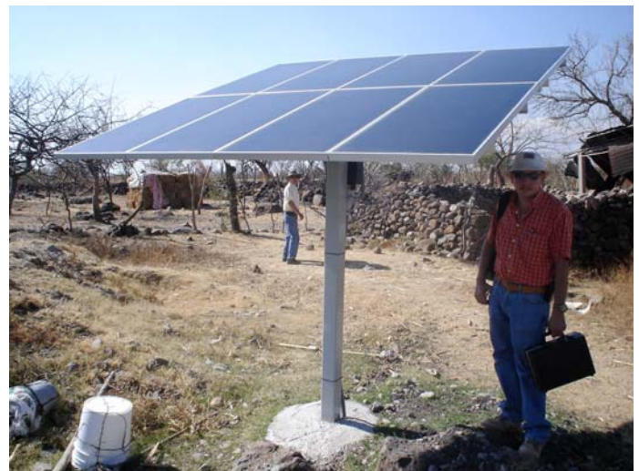
Fig. 9. El Corralito PV system array.
